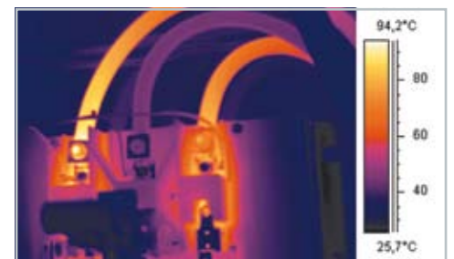
Schlechter Kontakt und innere Beschädigung
