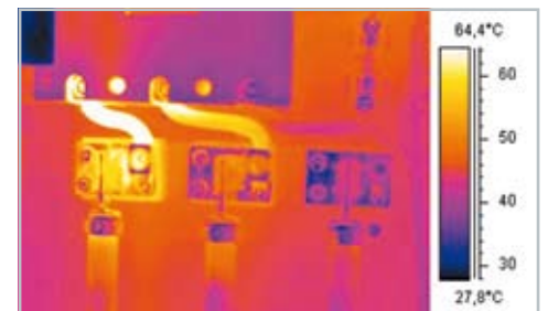
Anschluss mit hohem Übergangswiderstand
