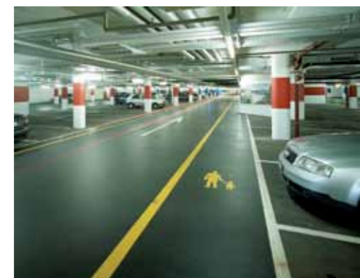
In Parkhäusern besonders wichtig: helle und zuverlässige Ausleuchtung.
